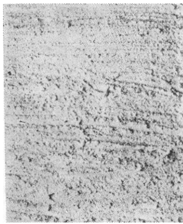
Kuva 61. »Talonpojan rappaus». Seinään on lyöty vetelähkö rappauslaasti, joka on tasoitettu typistetyllä varpuluudalla vaakasuoraan vetäen. Pinta on liian karkea sisärappauksiin.
